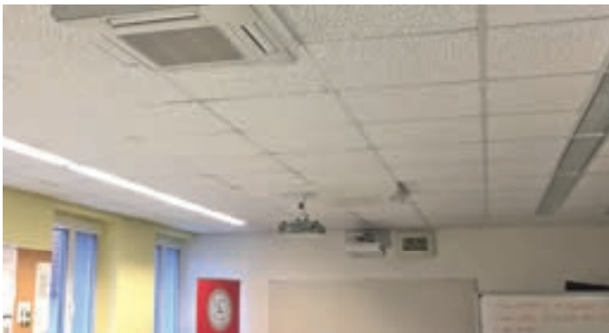
185 m 2 klimatisierte Fläche und 30,0 kW Gesamtkälteleistung
