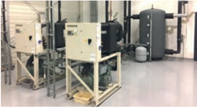
11.400 m 2 klimatisierte Fläche und 447,9 kW Gesamtkälteleistung
