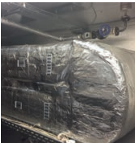
Vorher: Bauseitig vorhandener Zuluftkanal ohne Dampfleinbringung
