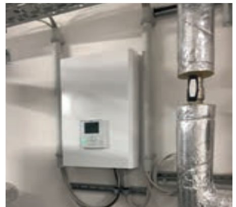
Fußbodenheizung und Warmwasserbereitung
