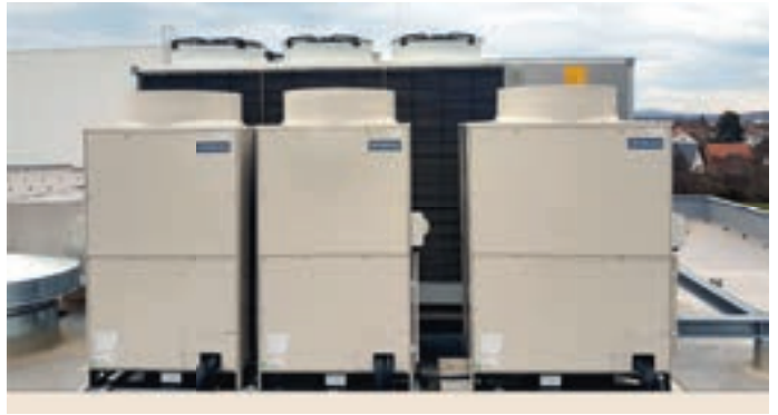
1.000 m 2 klimatisierte Fläche und 128,4 kW Gesamtkälteleistung
