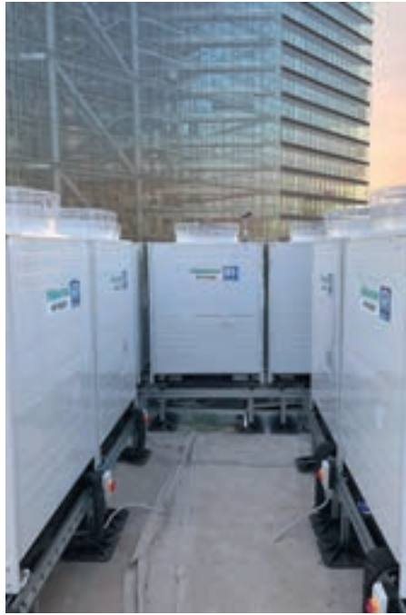
VRF-Außeneinheiten auf dem Gebäudedach
