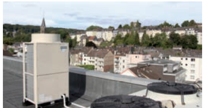
300 m 2 klimatisierte Fläche und 22,4 kW Gesamtkälteleistung
