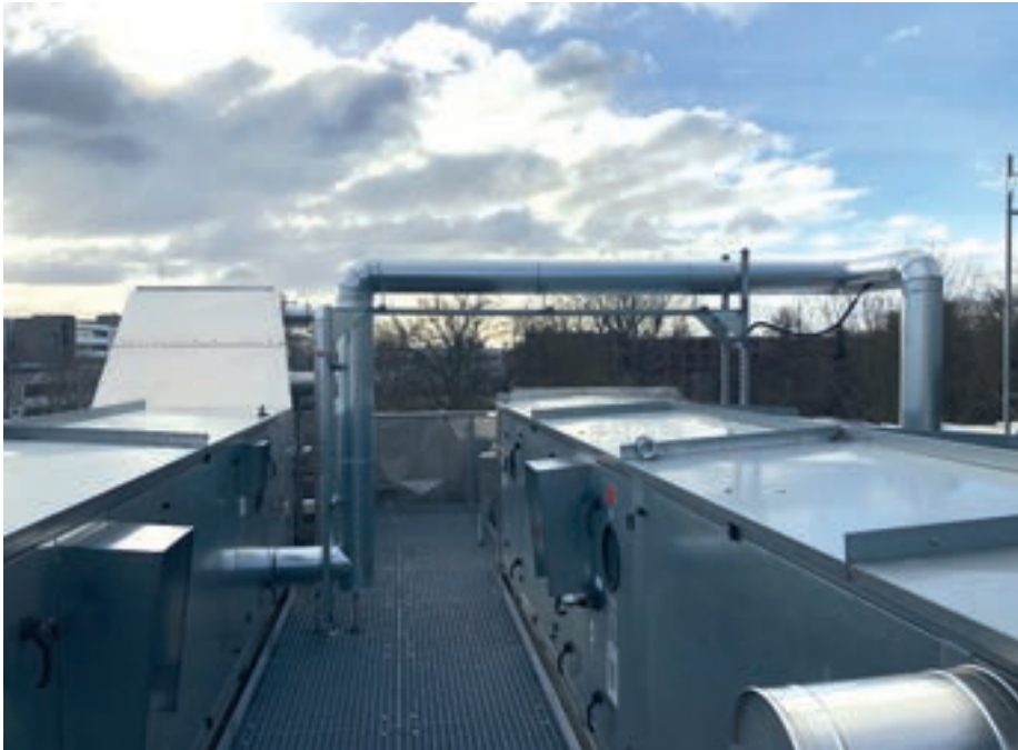
GTS-Dampfbefeuchter im Einsatz
