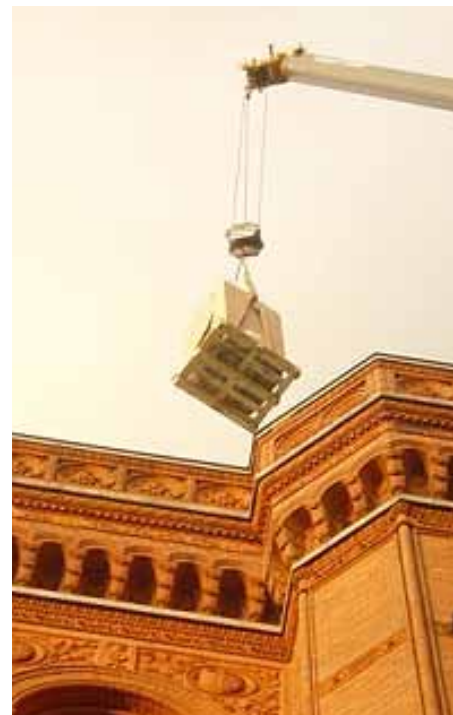
Mit Kränen mussten die Klimageräte auf das Dach des Hauses gehoben werden.
