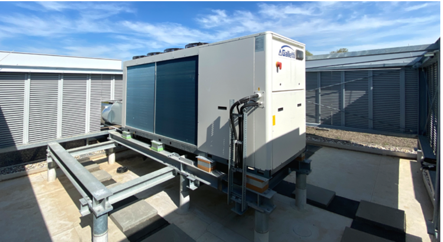
Die auf dem Gebäudedach aufgestellte Kältemaschine
