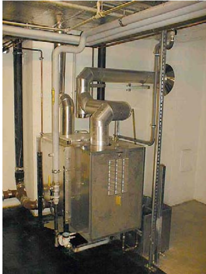
Bild 3: Gasdampferzeuger im Einsatz
