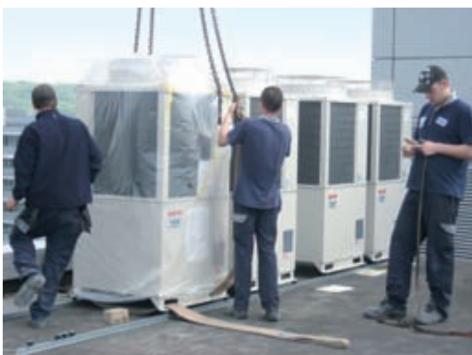
Die vier Außeneinheiten versorgen etwa 80 Inneneinheiten mit frischer Luft.
